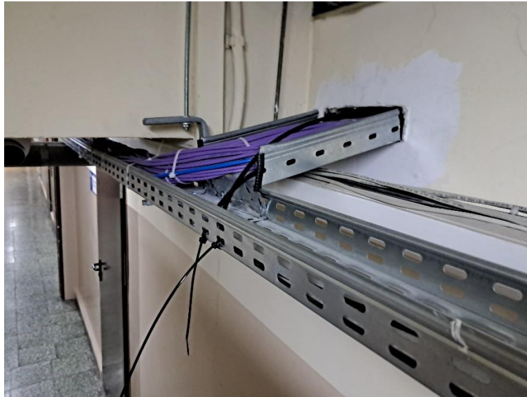
Rysunek 2 - wyjście z serwerowni koryto baks
